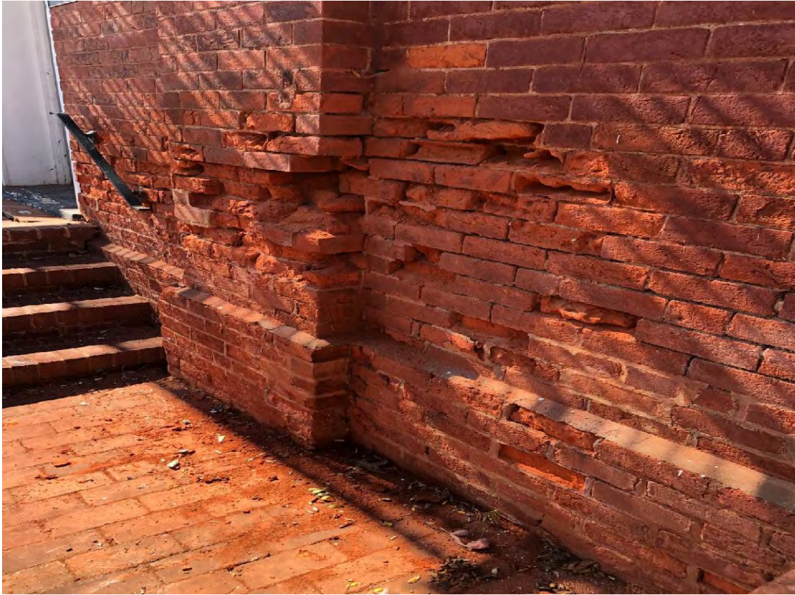
PHOTOS 9A & 9B – BRICK DETERIORATION ACTUAL CONDITIONS
